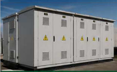
ENERJİ SANTRALİ – KONTROL PANOLARI
