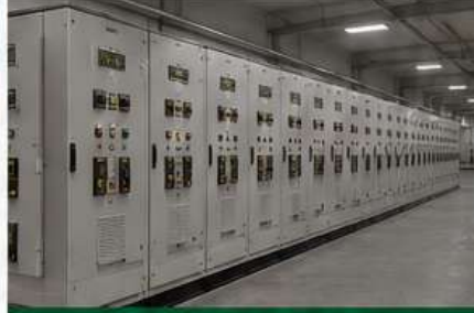
FABRİKA TESİSİ – MCC PANOLARI
